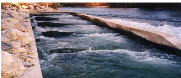
Photographie 11 : Passe à seuils déversants et fentes verticales - Bédarrides (84) - rivière Sorgues (GEI/SIEE)
