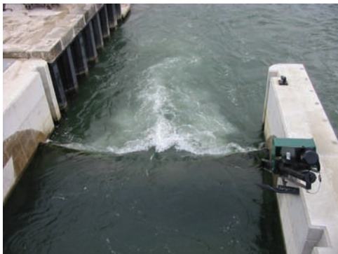
Photographie 27 : Vanne de régulation passe à poissons barrage Jaulnes (77) – rivière Seine (GEI/SIEE)
