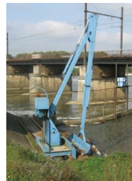
Photographie 33 : Dégrilleur automatique (GEI/SIEE)
