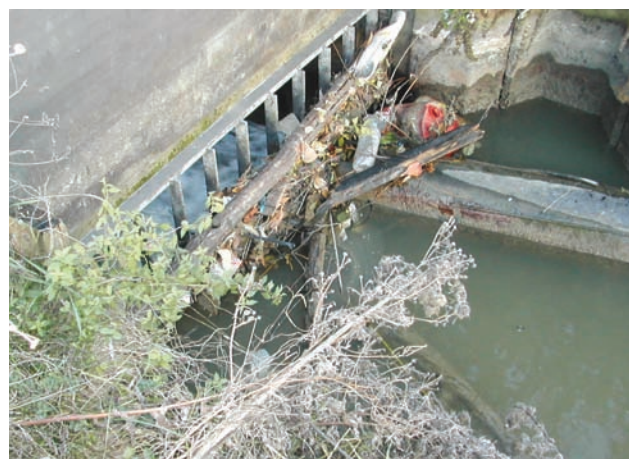
Photographie 29 : Colmatage de la prise d'eau (GEI /SIEE)
