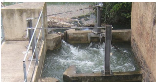
Photographie 28 : Colmatage de la prise d'eau (GEI /SIEE)
