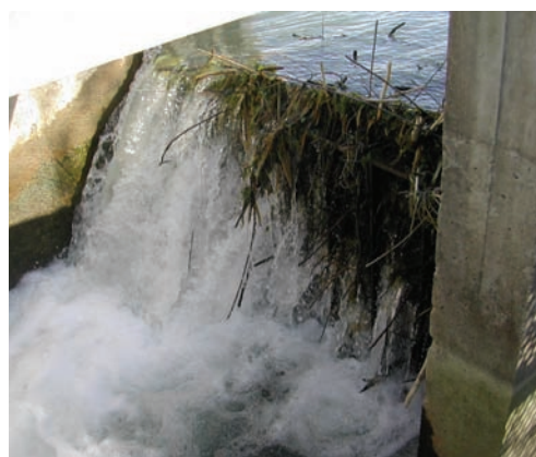
Photographie 30 : Colmatage de la prise d'eau – (GEI /SIEE)
