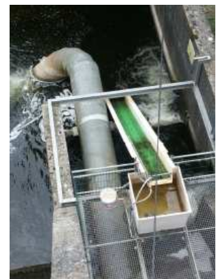
Passe piège à anguilles sur le barrage de Moulin Neuf sur le Pont Labbé (FDPPMA29)
