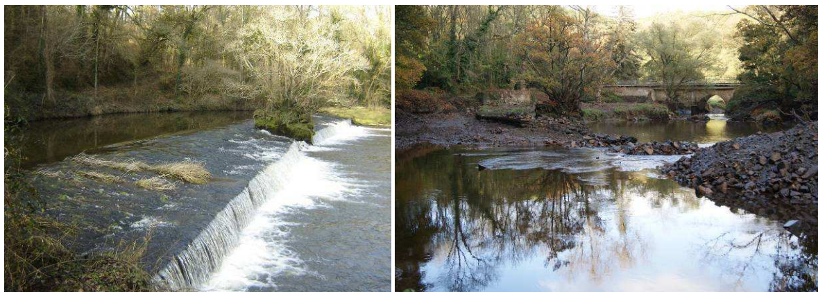
Seuil du Houël sur le Leff avant démolition (FDPMA22, 2010) et après démolition (FDPMA22, 2010)
