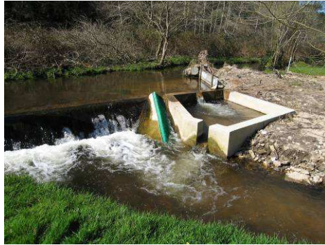
Passe à poissons du moulin de Trémillec sur la rivière Pont Labbé (BGM, 2009)
