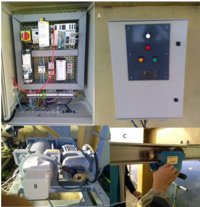
FIGURE 6 – A Armoire électrique de commande du treuil, déportée sur la pile, B treuil avec codeur incrémental, C chariot de levage et de positionnement du didson (pour la sécurité).
