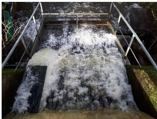
Figure 56 : Nouvelle grille de dévalaison installée en Novembre 2020 (Fish-Pass)
