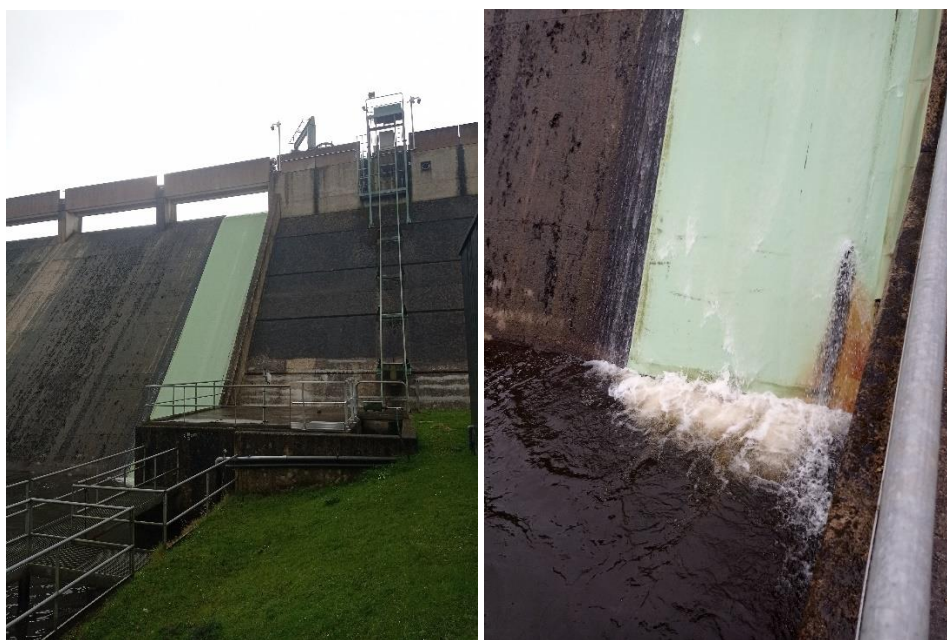
Figure 71: Barrage de Bois Joli avec un bidim de protection (Fish-Pass)
